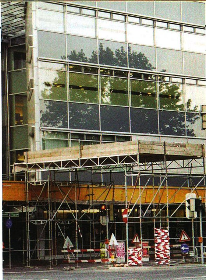
Barrikaden. Das Entree des IZD-Towers ist durch eine provisorische Schutzdecke schwer beeinträchtigt.
